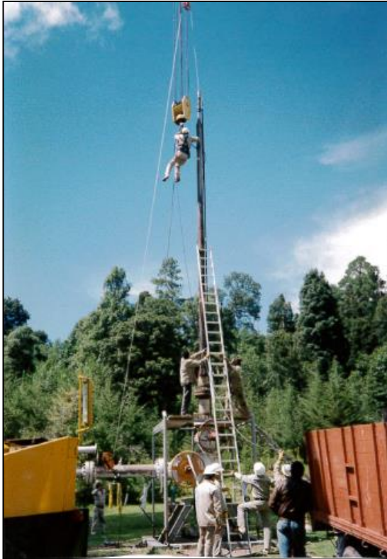
Fig. 3. Instalación del lubricador para un registro con la sonda PTS.
